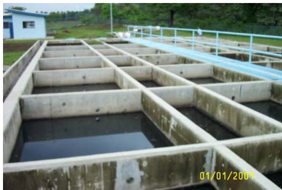
Fig. 3 Vista general del Imhoff, El Viejo.
